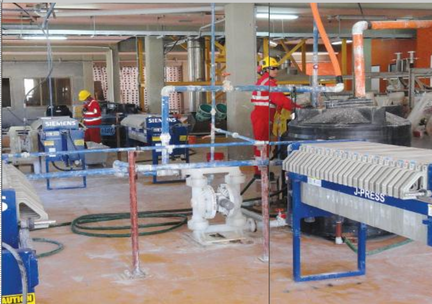
Planta Piloto de Carbonato de litio
