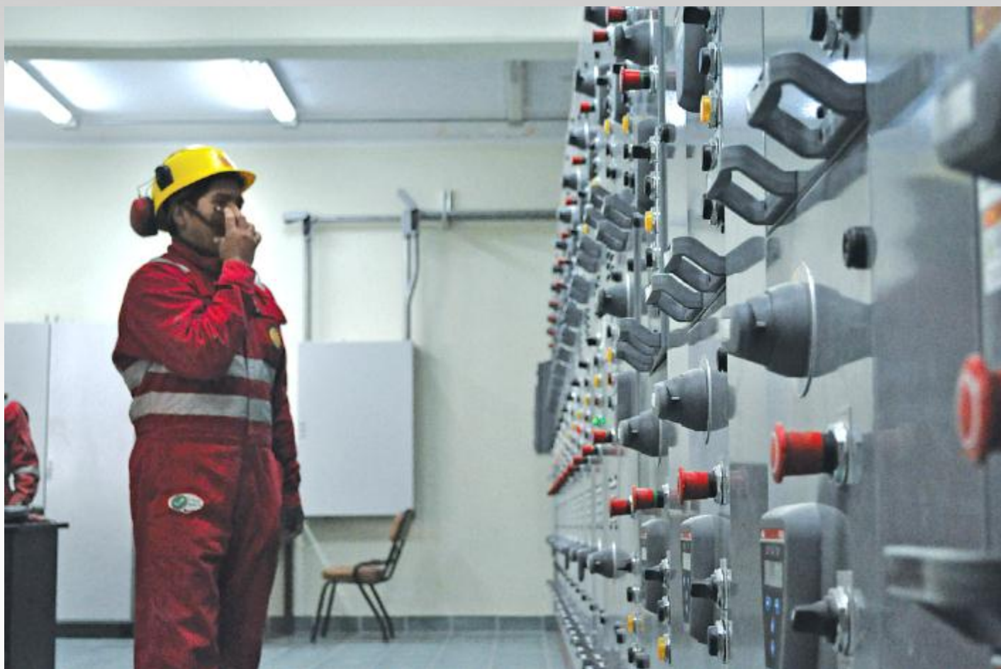
Centro de control de Planta Piloto de Carbonato de litio
