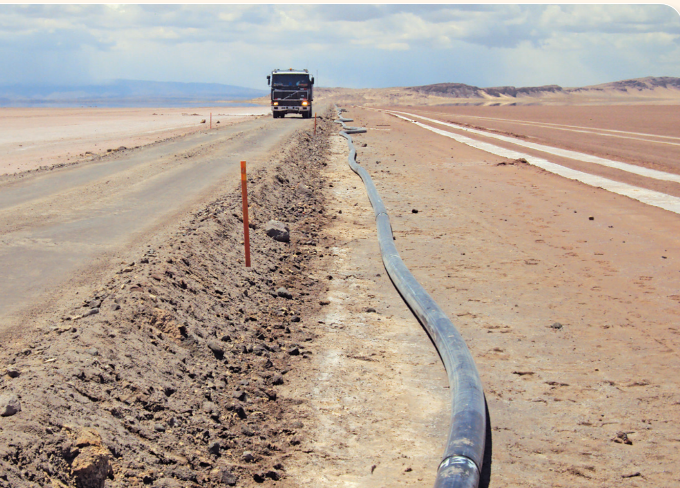
Ducto de agua potable conectado desde los tanques de almacenamiento de Llipi
