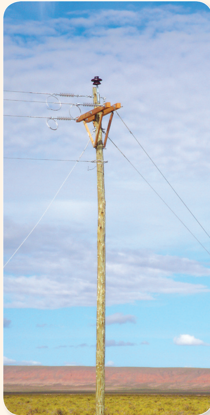
Instalación eléctrica de media tensión
