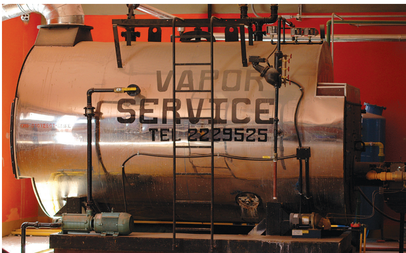
Caldero de presión para la generación de vapor que es utilizado en el proceso de obtención de carbonato de Litio
