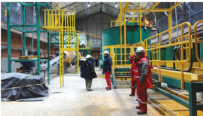
Instalaciones de la Planta de encalado
