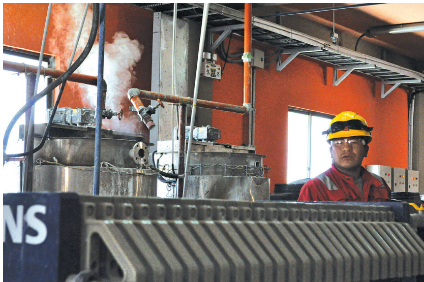
Trabajador de la GNRE operando el filtro prensa de la Planta Piloto de Carbonato de Litio
