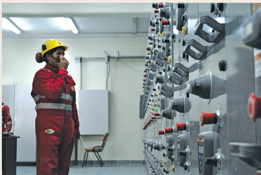
Centro de Control de Motores de la Planta Piloto de Carbonato de Litio
