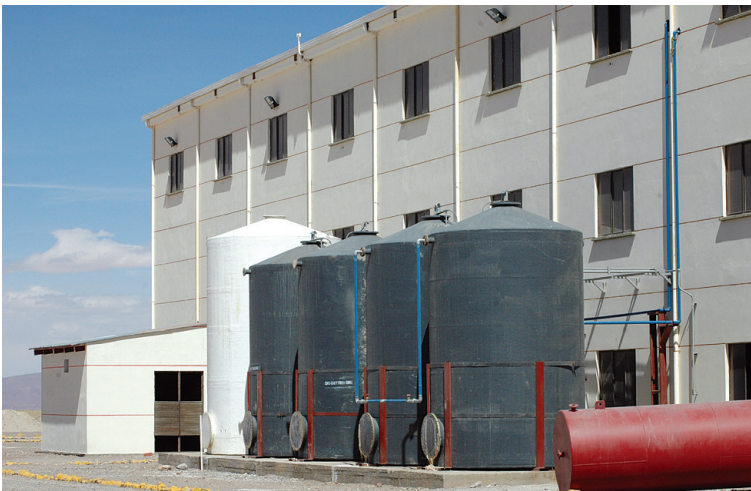
Tanques de almacenamiento de concentrados de Litio
