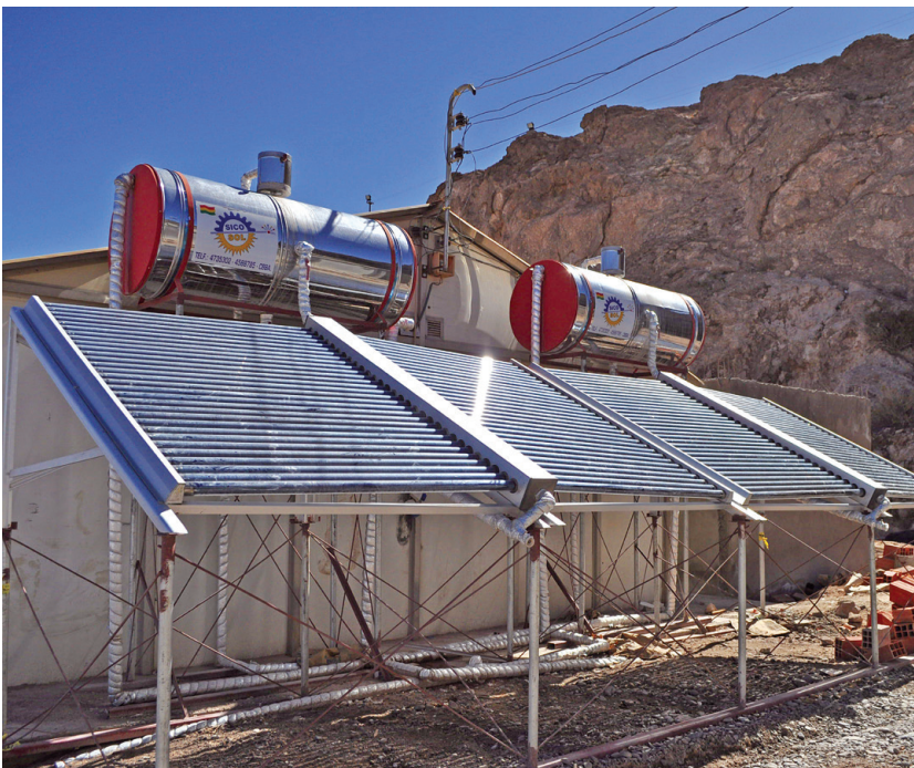
Calefacción de agua a energía solar instalado en campamento de Llapi
