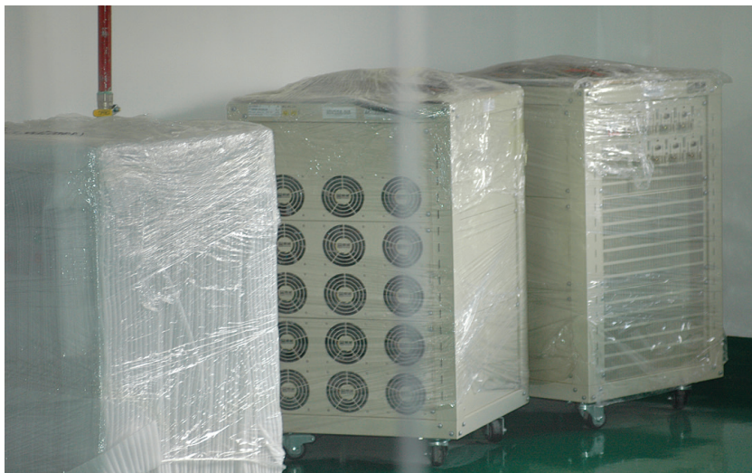
Equipos de Planta Piloto de baterías de Litio a ser instalada en La Palca
