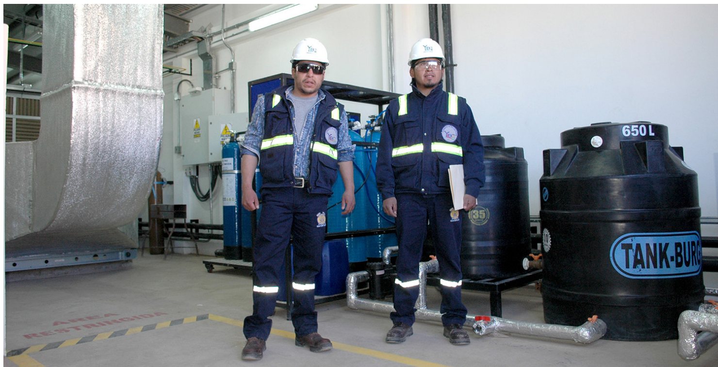
Técnicos de YLB en la Sala de Máquinas de la Planta Piloto de Materiales Catódicos
