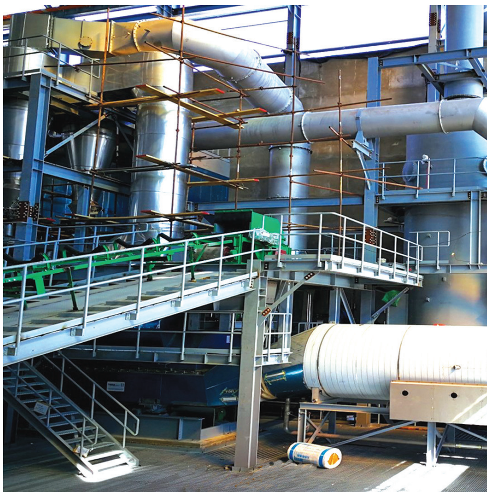
Parte de las instalaciones de la Planta Industrial de Cloruro de Potasio
