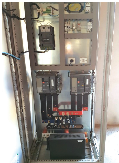
Vista interna del tablero de transferencia automática
