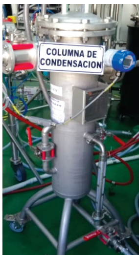
Columna de condensación
