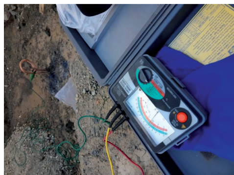
Medición de resistencia de aterramiento independiente para el FRX 4.5 Ω
