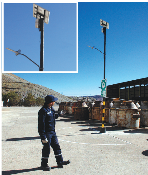
Instalación de panel solar con batería de Litio ensamblado en la Planta Piloto de La Palca
