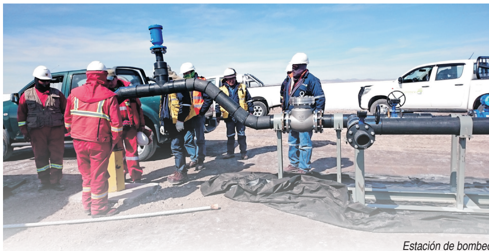
Estación de bombeo
