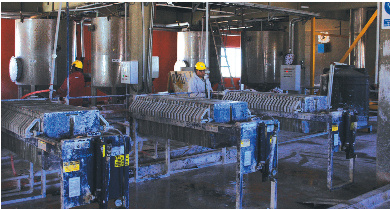
Tanques reactores reactores y filtros prensa de la Planta Piloto de Carbonato de Litio
