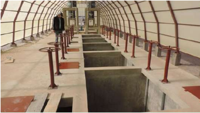
Exterior e interior de la Planta de Tratamiento de aguas industriales
