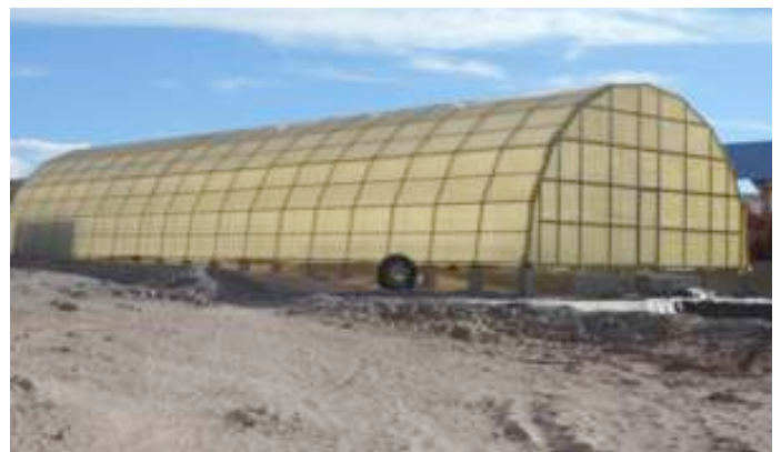
TINGLADO METALICO C/CARPA SOLAR P/MEJORAR LA REMOCIÓN DE LA PTAR.D, PARA AUMENTAR LA TEMPERATURA DEL AGUA
