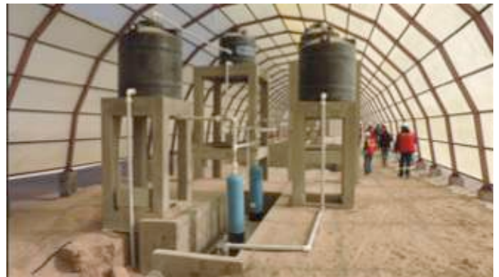
TANQUES ELEVADOS DE HºAº PARA ALMACENAMIENTO DE AGUA TRATADA, PARA ALMACENAMIENTO DE REGENERANTES, INFRAESTRUCTURA PARA DESIONIZADORES (+) Y (-) Y DESIONIZADORES.
