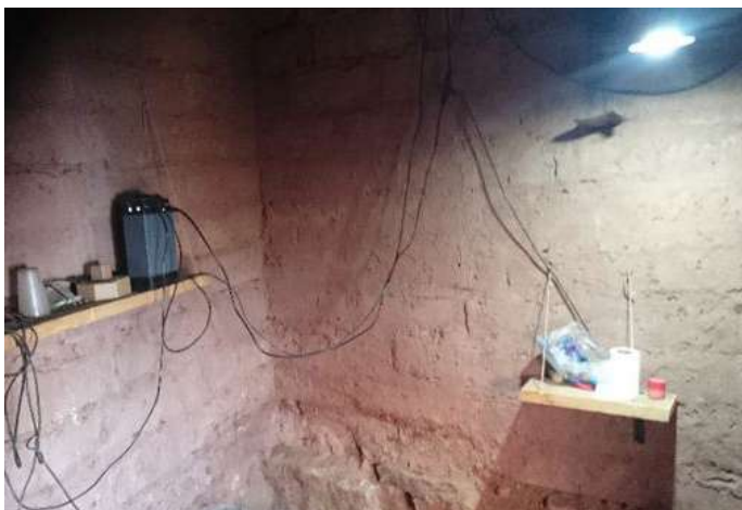
Sistema fotovoltaico en uso en vivienda rural de Chiracoro
