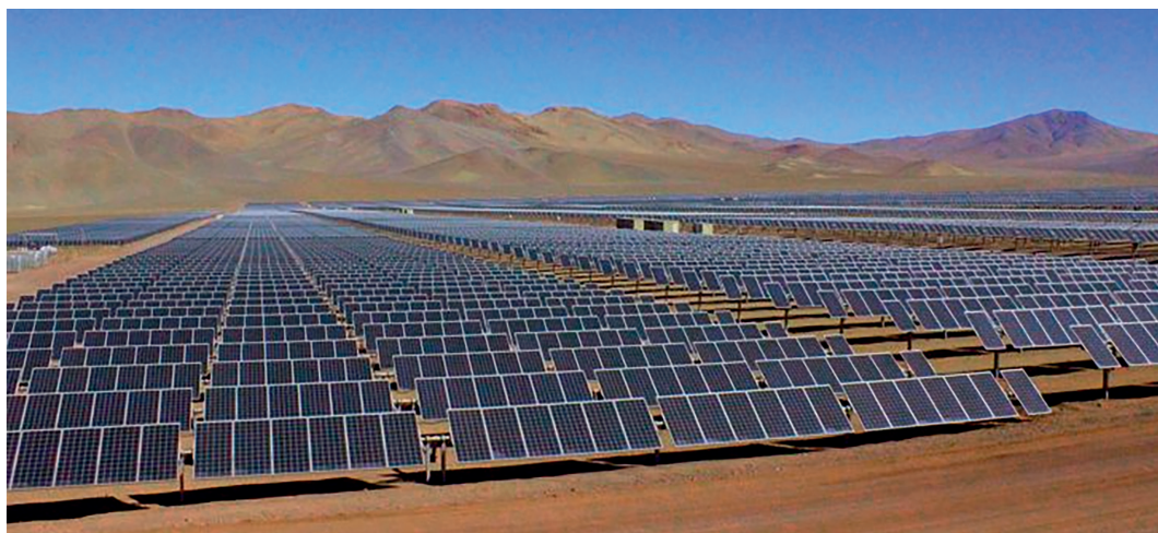
Campo de paneles solares en el desierto de Atacama, Chile.
